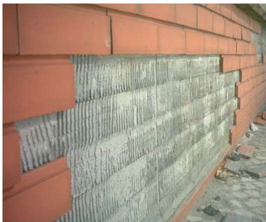
Figura 1 – Visibilidade dos cordões de cola resultantes de deficiente execução do assentamento dos ladrilhos
