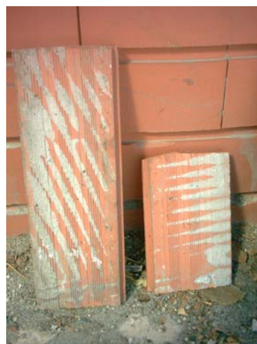
Figura 2 – Tardo de ladrilhos evidenciando assentamento deficiente dos ladrilhos
