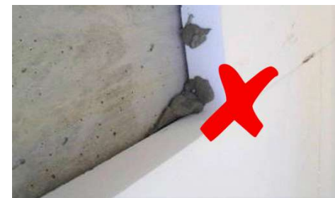
Refluir de argamassa
