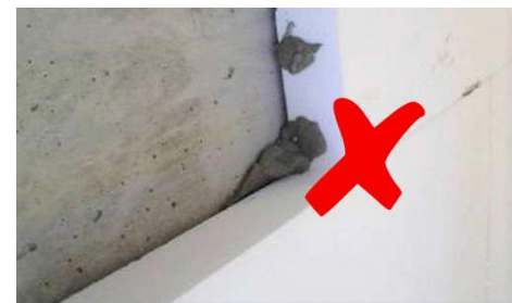
Refluir de argamassa
